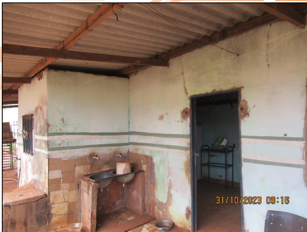
Imagem 10: Área de serviço.
