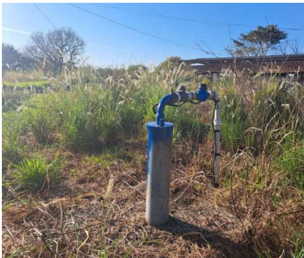
POÇO ARTESIANO LEGALIZADO
