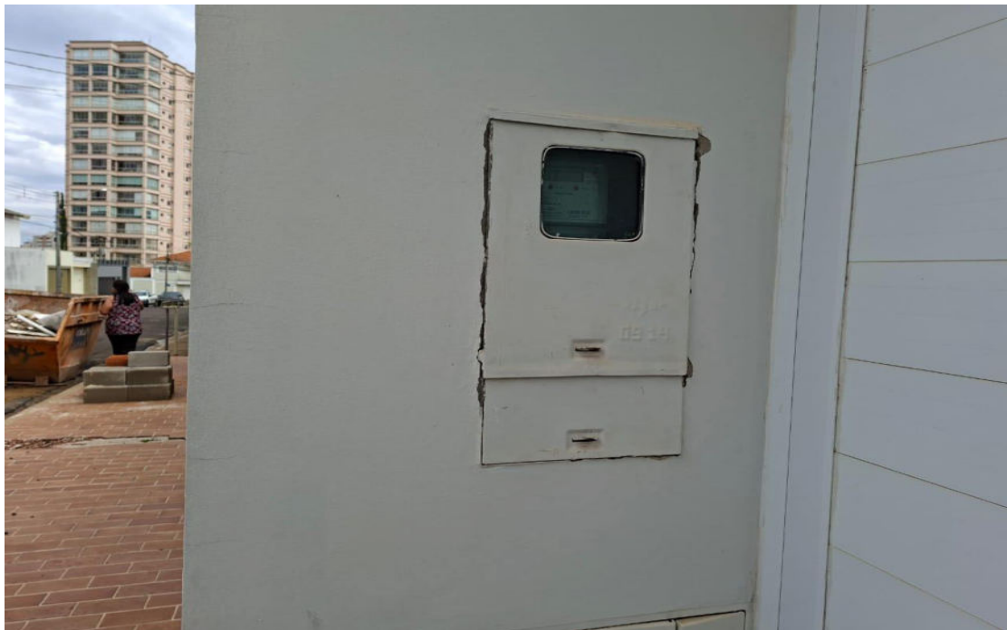
Medidor de energia
